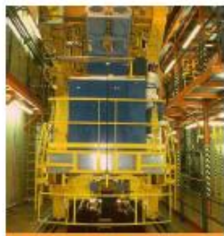
Le déchargement des assemblages combustibles du cœur du réacteur
