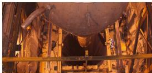
Démantèlement des tunnels « secondaires » de 18 mètres de haut qui supportaient les pompes secondaires et une partie des circuits de sodium secondaire (2011-2015)
